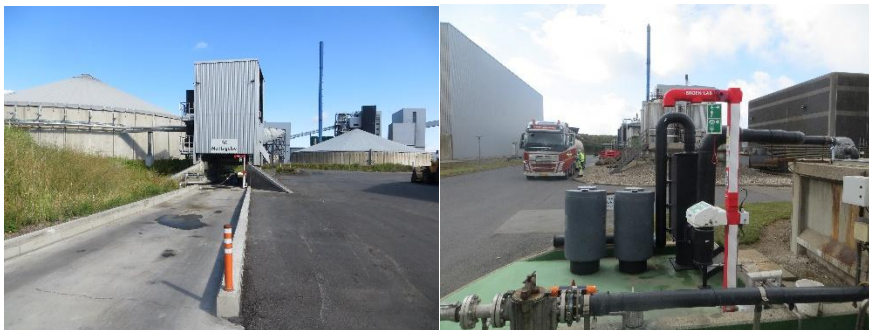
Læsseplads til lagertanke og læsseplads til modtagetank
