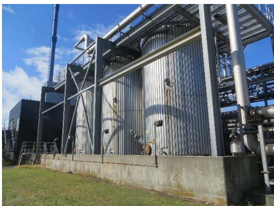
Slopeolleanlægget tank 82.01, 82.02 og 82.03
