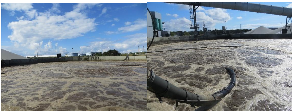
Nye procestanke, tank nr. 252.02 og 252.01
