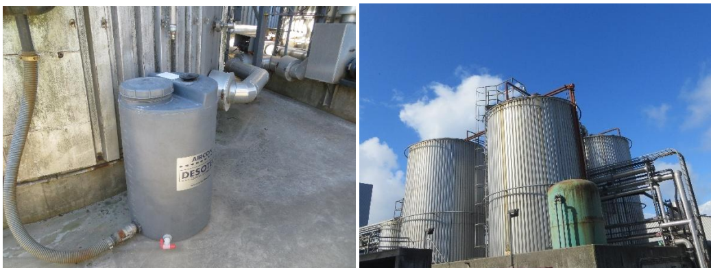
Kulfilter til 6 tanke, tank 80.01 -80.02– 81.01- 81.04
