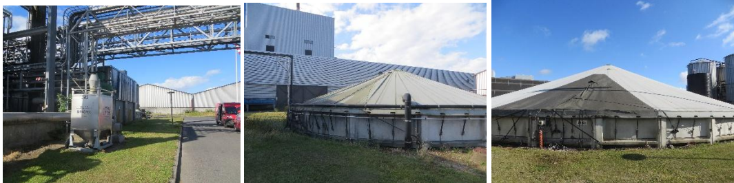
Kulfilter på lagertank 61.03 og 31.08
