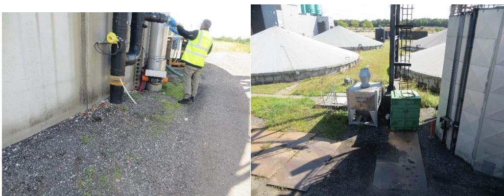
Til højre Installation til at føre tankluft over i procestanke til beluftning. Til venstre Kulfilter der er taget ud af drift.
