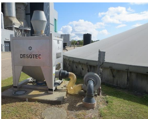
Kulfiltre og blæser på 4 tanke, tank 31.01-31.04
